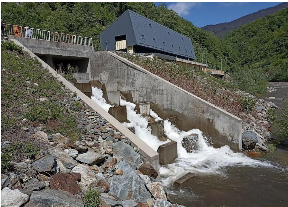
Fig. 182 Întreruperea conectivității longitudinale la nivelul confluenței pâraului Dumitra cu râul Jiu
