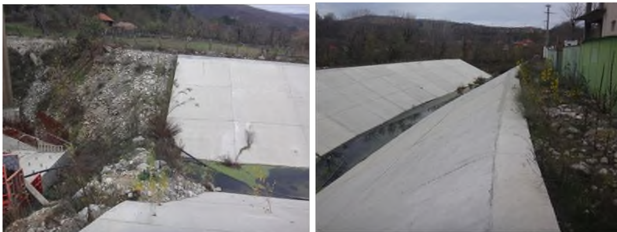
Fig. 21 Canalul de fugă la racordul cu bazinul de liniștire și vedere în lung
