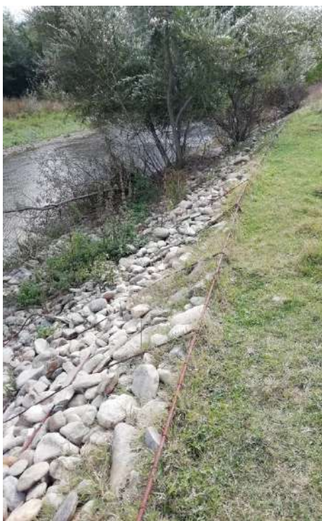
Foto 6 Praguri distruse, stadiul lucrărilor
